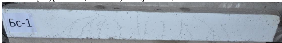
Рис. 1. Балка Бс-1 з тріщинами після випробовувань
