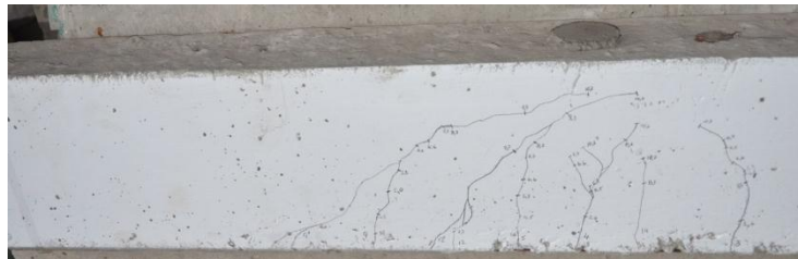
Рис. 2. Тріщини дослідних балкових зразків Бс-1 та Бс-2
