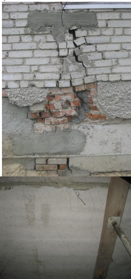
Рис. 2. Тріщини в несучій зовнішній стіні будівлі
