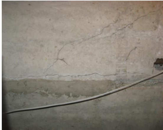
Рис. 3. Тріщини у плитах перекриття над підвалом
