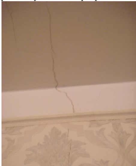
Рис. 4. Тріщини у швах плит перекриття, що переходять на стіни
